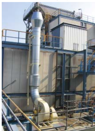
Schoorsteen van de nieuwe stofzuiginstallatie
